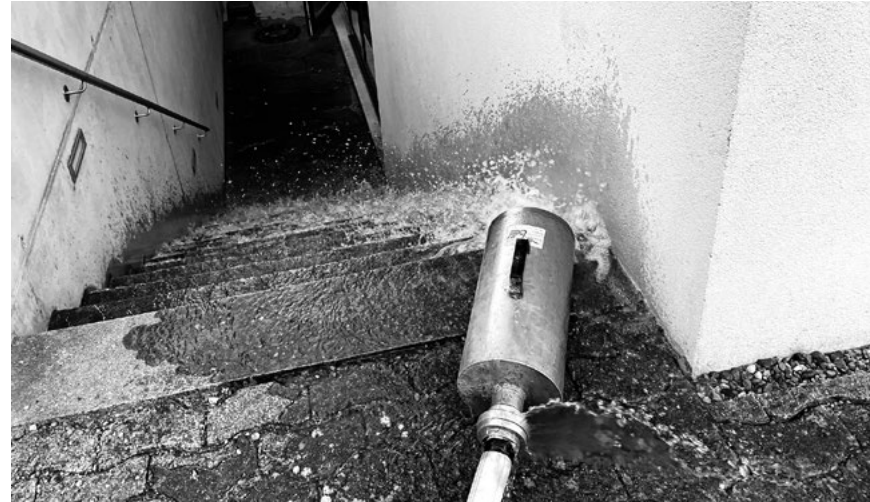
Durch gezieltes Wässern konnte ein Wassereintritt durch die undichte Gebäudehülle festgestellt werden.
